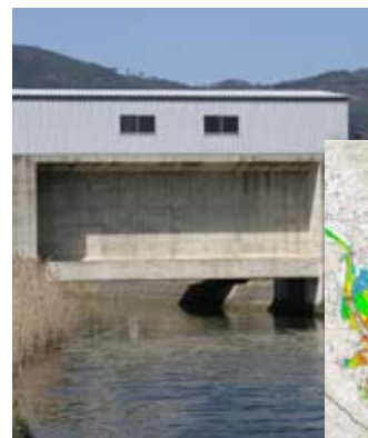
津波対策用浜田川水門
